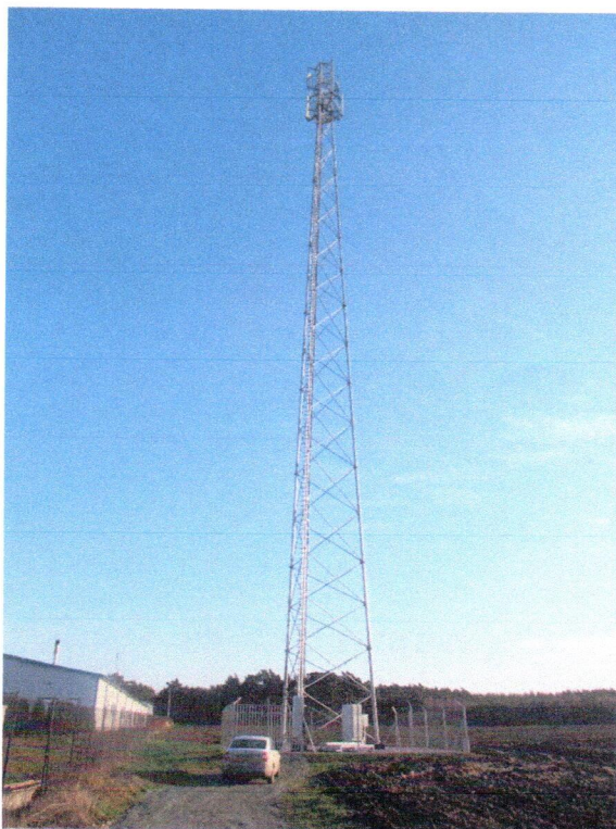
Zał. nr 1: Widok ogólny instalacji radiokomunikacyjnej.
